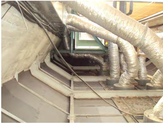
IM 05 Sustentación de climatizadoras. Sala 9.
